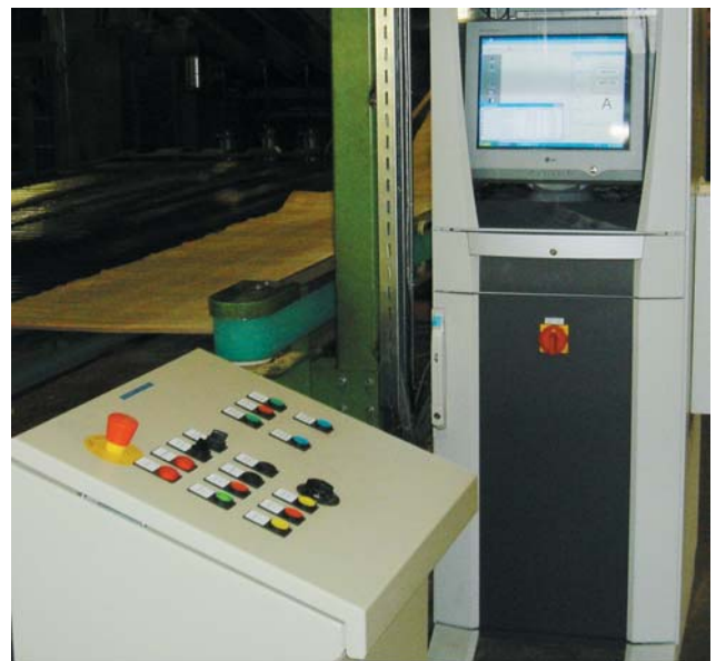
Bedienkonsole und Schaltschrank
